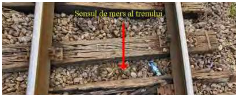
Foto nr.6 - starea tehnică a traversei T-13
