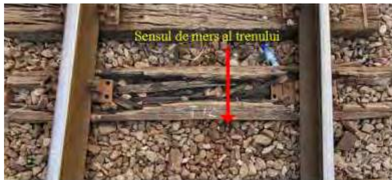
Foto nr.7 - starea tehnică a traversei T-12
