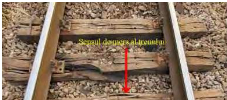
Foto nr.8 - starea tehnică a traverselor T-11 și T-10
