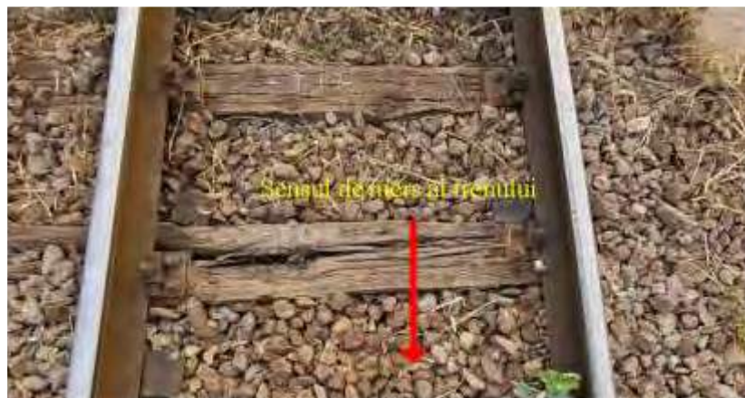
Foto nr.4 - starea tehnică a traverselor T-17 și T-16
