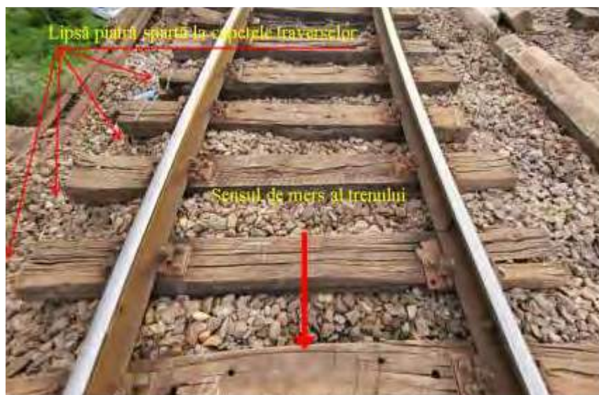
Foto nr.12 - lipsa pietrei sparte la capetele traverselor
