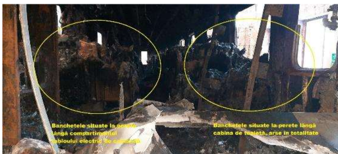
Imaginea nr.11 - starea banchetelor din capătul compartimentului alăturată incendiului
