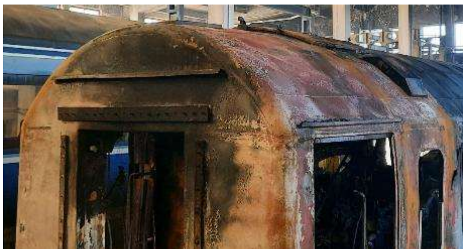
Imaginea nr.6 - acoperiș deformat al cutiei vagonului în zona cabinei de toaletă
