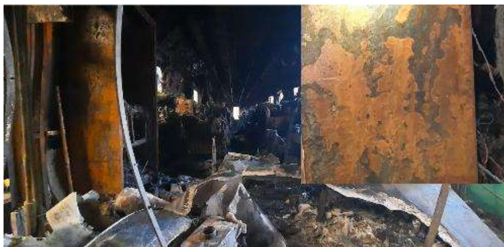
Imaginea nr.10 – zona tabloului electric de comandă al vagonului cu detaliu al afectării termice a cutiei acestuia
