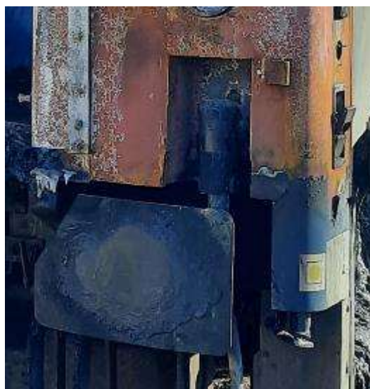
Imaginea nr.5 - cupla electrică a vagonului nr.50532049112-7, capăt cu vagonul nr.50532049115-0
