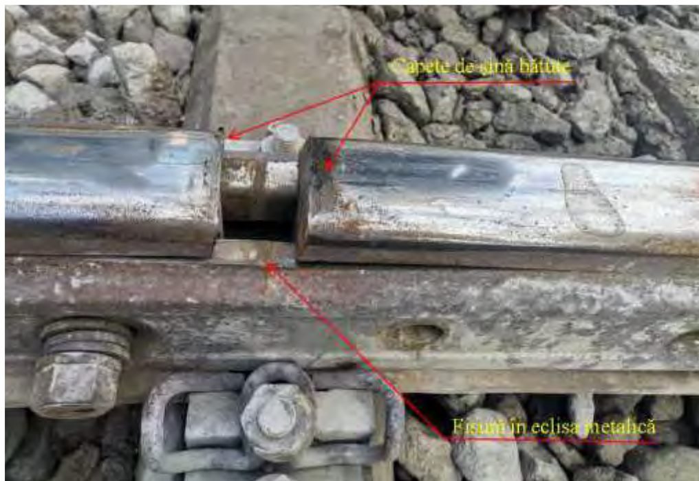
Foto nr.5. Capete de șine bătute în dreptul joantei și fisură în eclisa metalică
