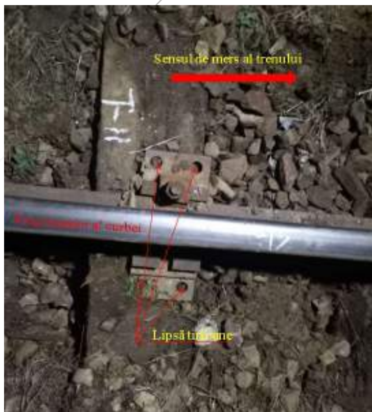
Foto. nr.3 – Starea tehnică a traversii T-11
