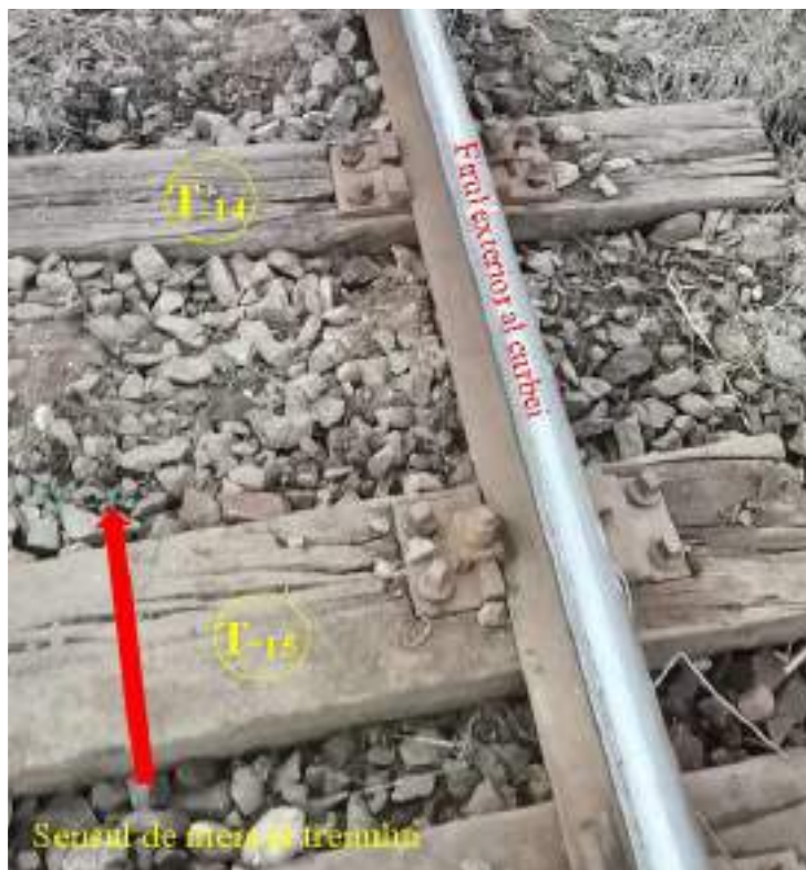
Foto. nr.2 – Starea tehnică a traverselor T-15 și T-14
