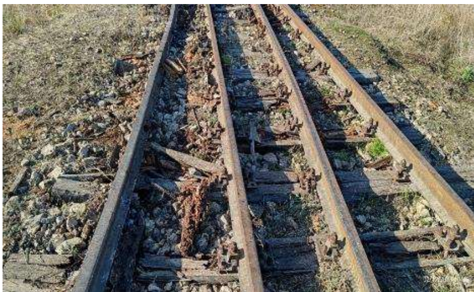
Foto nr. 2 – starea traverselor din cuprinsul schimbătorului de cale nr.13
