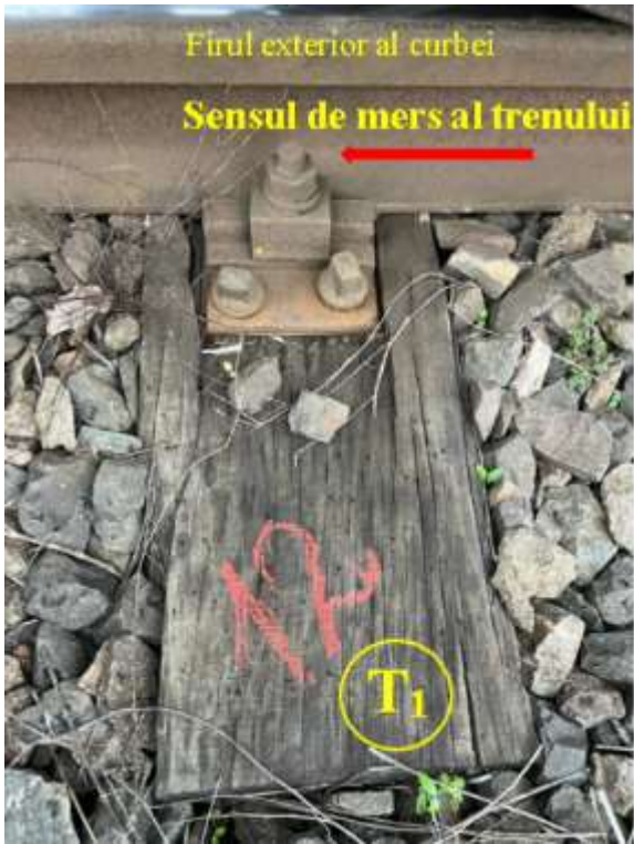
Foto nr.17 - Capătul traversei T 1 pe firul exterior
