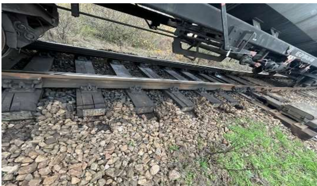
Foto nr.9 – Deriparea pe zona macazului
