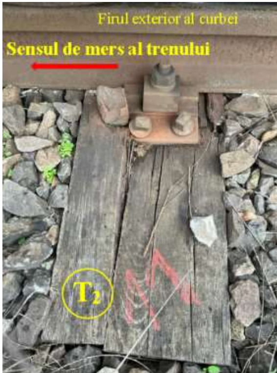
Foto nr.19 - Capătul traversei T 2 pe firul exterior
