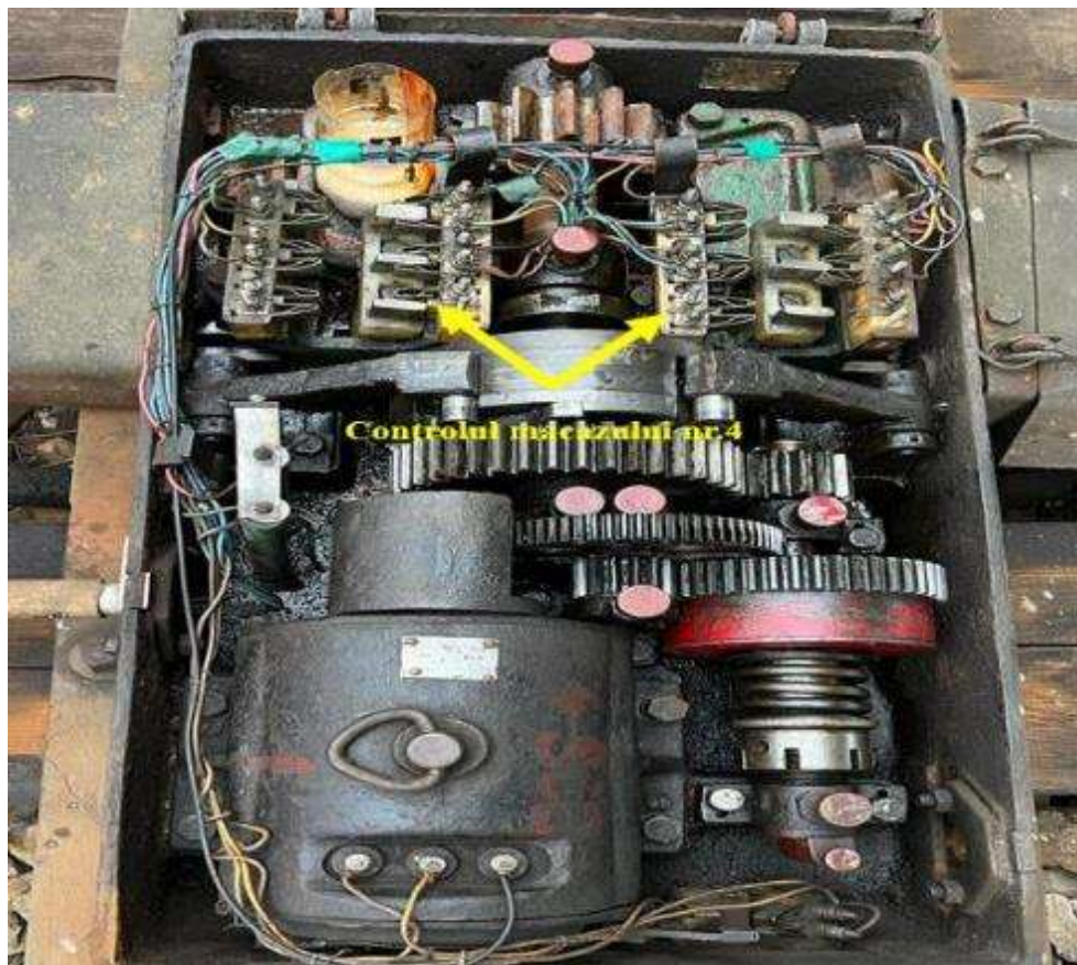
Foto nr.41 - Controlul macazului nr.4
