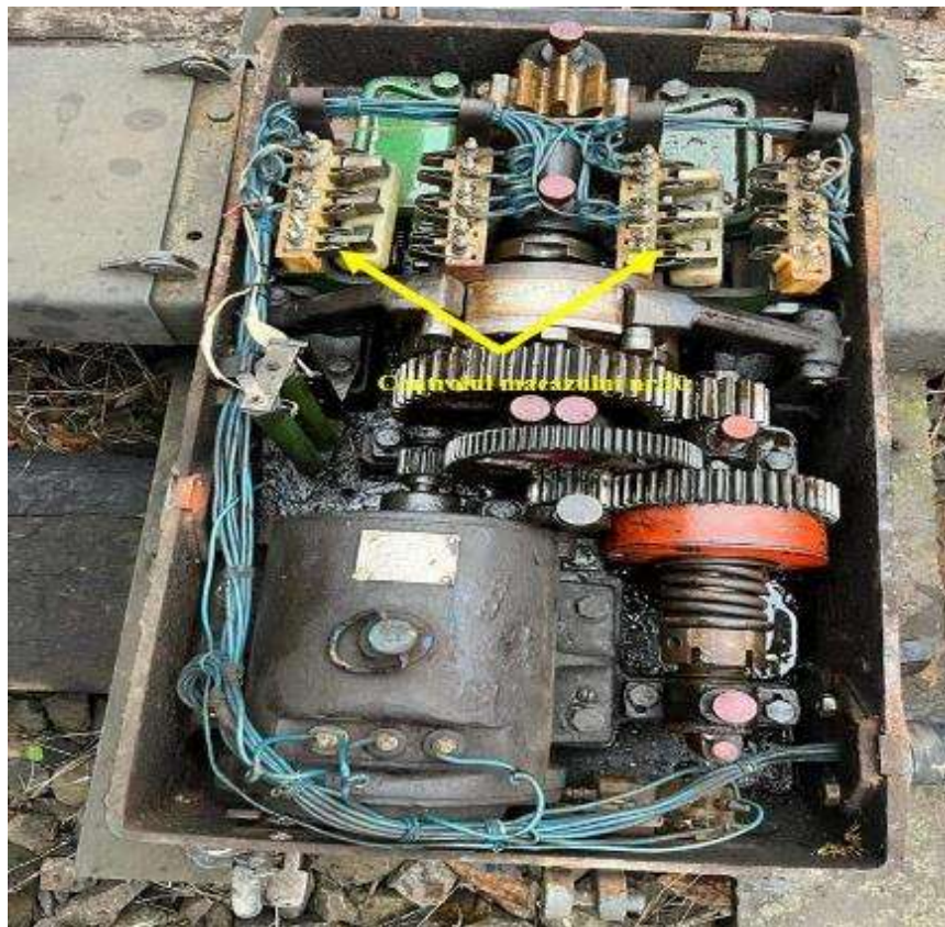
Foto nr.39 - Controlul macazului nr.10
