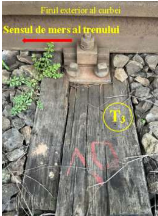
Foto nr.21 - Capătul traversei T 3 pe firul exterior
