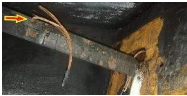
Imaginea nr. 7 – cablu electric sudat de platbanda din spatele convertizorului
