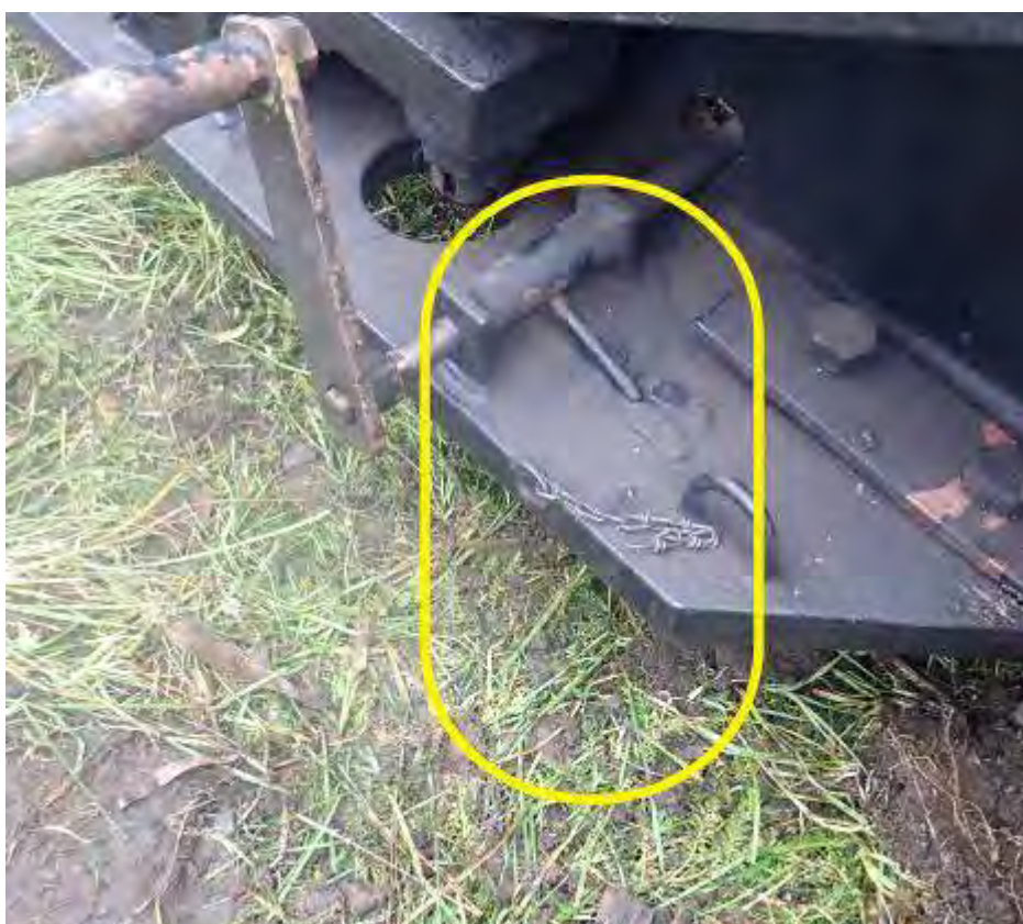
Foto nr.10 – siguranța de la boghiul nr.2 - ruptă
