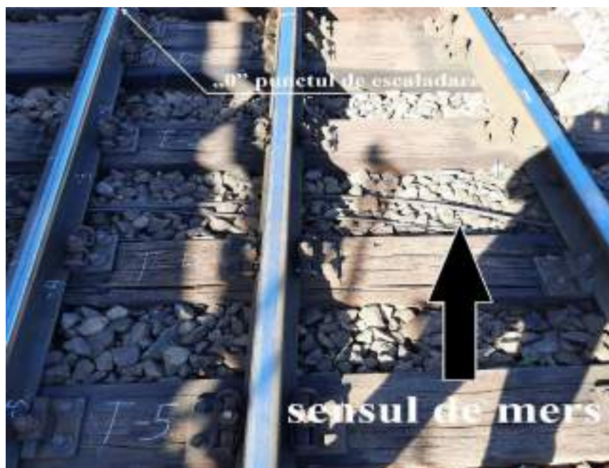
Foto nr.5 - suprastructura căii în zona punctului de deraiere
