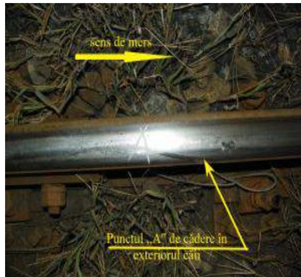
Foto nr.5: Punctul „A” – prima urmă de cădere în exteriorul căii (roata din dreapta a osiei nr.1)
