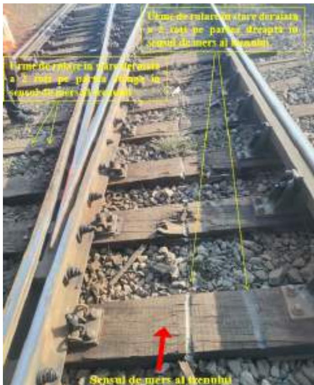
Foto nr.6 – Urme de rulare în stare deraiată
