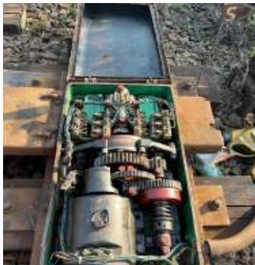
Foto nr.19 - Controlul macazului nr.5
