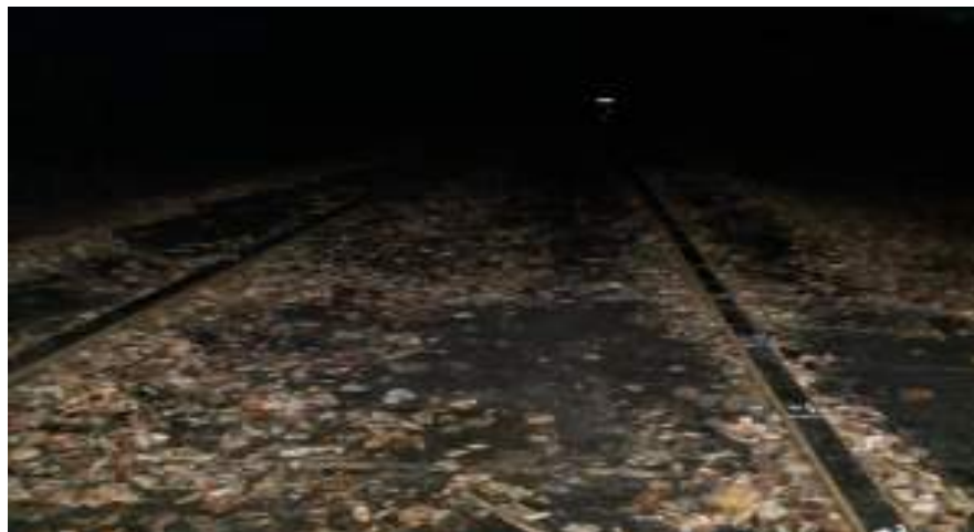
Imaginea nr.7 – Traversele de beton acoperite cu piatră spartă colmatată cu praf de cărbune
