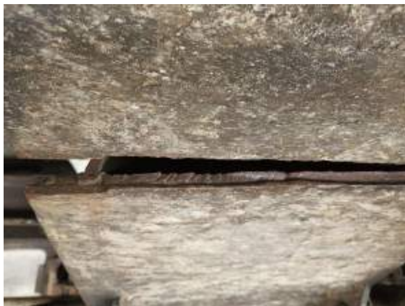
Foto nr.9 – Rupere la placa inferioară a traversei crapodinei în zona de îmbinare prin sudură
