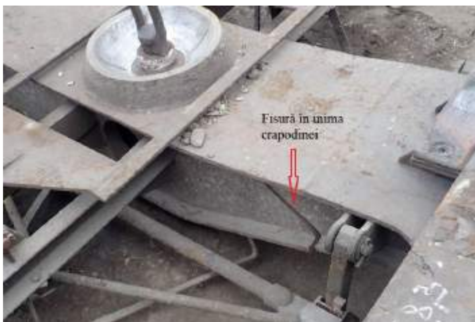
Foto nr.6 – Fisură în prima inimă a crapodinei de la placa inferioară spre placa superioară
