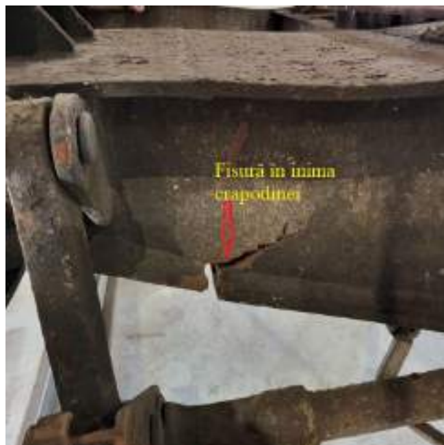
Foto nr.8 – Fisură în cea dea doua inimă a crapodinei de la placa inferioară spre placa superioară
