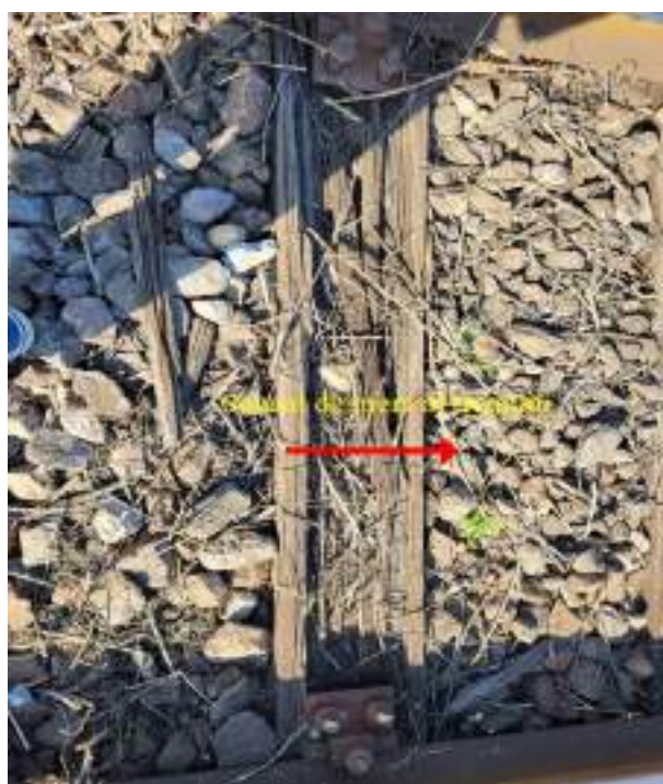
Foto. nr.12 – Starea tehnică a traversei T 15
