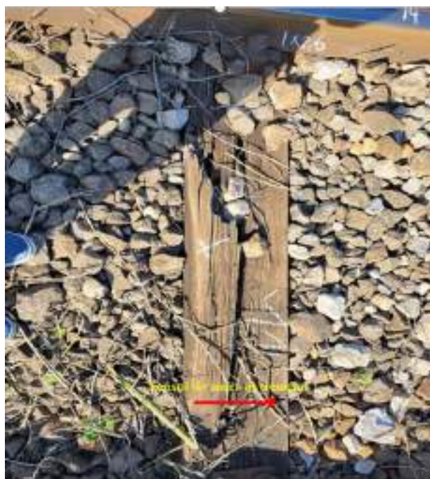
Foto. nr.11 – Starea tehnică a traversei T 11
