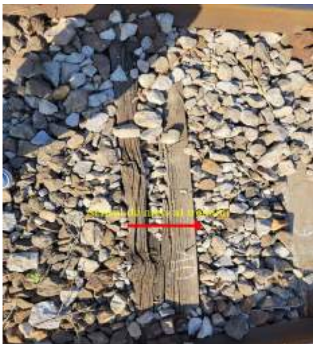
Foto. nr.10 – Starea tehnică a traversei T 10
