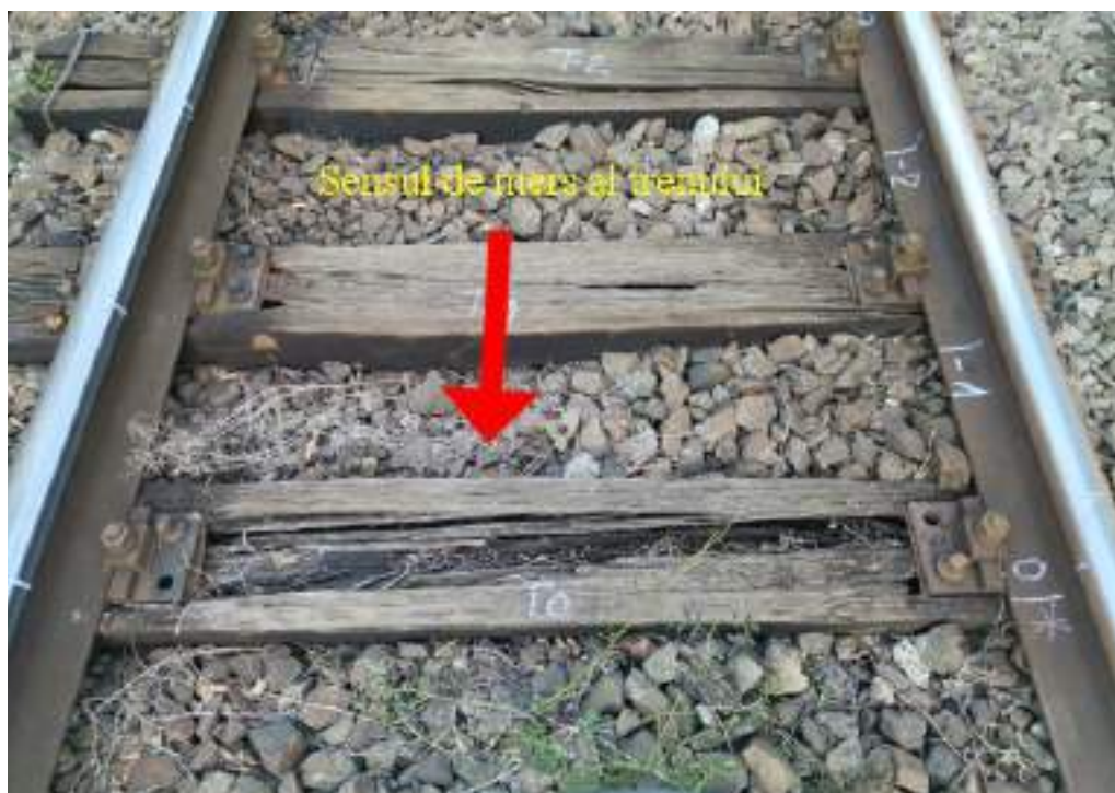
Foto. nr.5 – Starea tehnică a traverselor T 0 , T -1 și T -2
