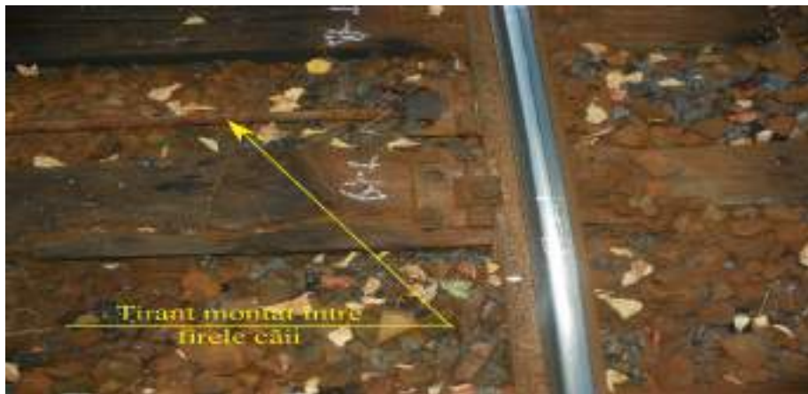
Foto.nr.7 - Tirant montat între firele căii
