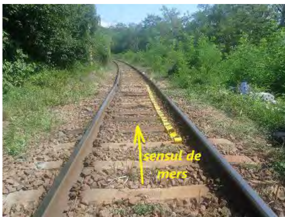
Foto nr.1 – zona producerii accidentului
