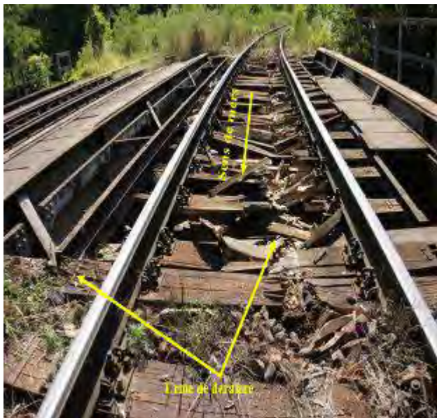
Foto nr.10 – Urme de deraiere
