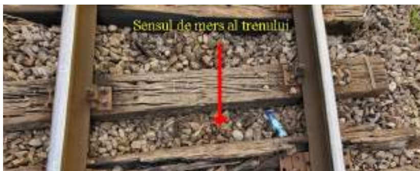
Foto nr.6 - starea tehnică a traversei T-13
