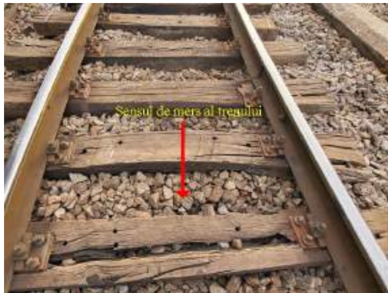
Foto nr.11 - starea tehnică a traverselor T1, T 0 , T -1 , T -2 și T -3
