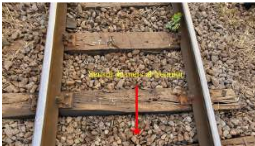
Foto nr.5 - starea tehnică a traverselor T-15 și T-14
