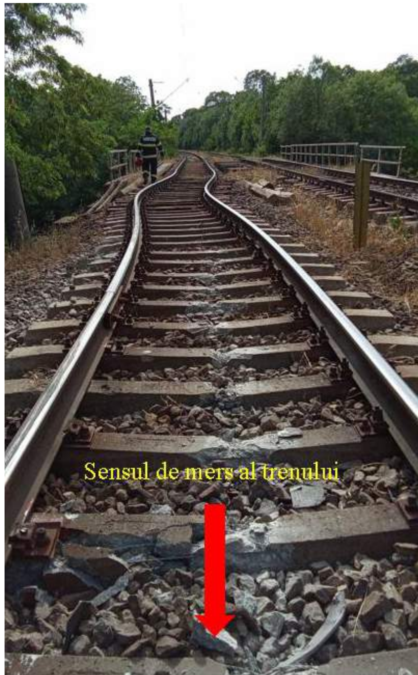
Foto nr.3 - Deformația transversală văzută din sensul invers de mers al trenului
