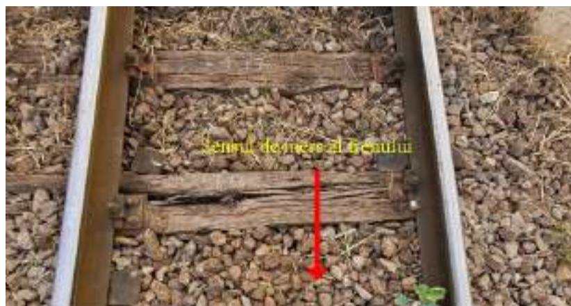
Foto nr.4 - starea tehnică a traverselor T-17 și T-16
