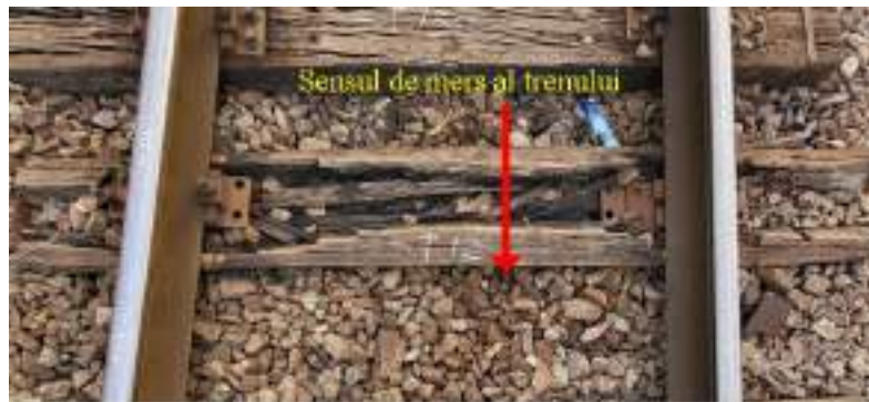
Foto nr.7 - starea tehnică a traversei T-12
