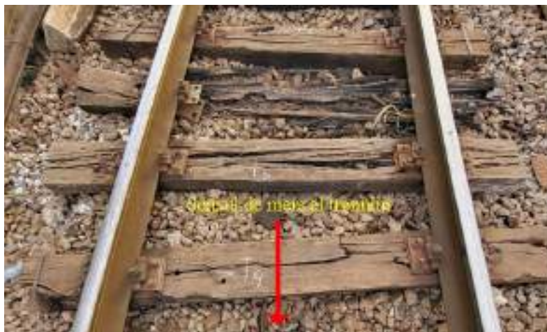
Foto nr.10 - starea tehnică a traverselor T-7, T-6, T-5 și T-4
