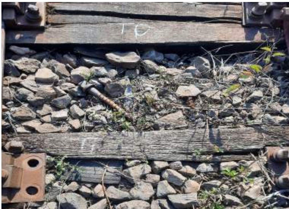
Foto nr.2 – traversa T0 din cuprinsul schimbătorului de cale nr.37
