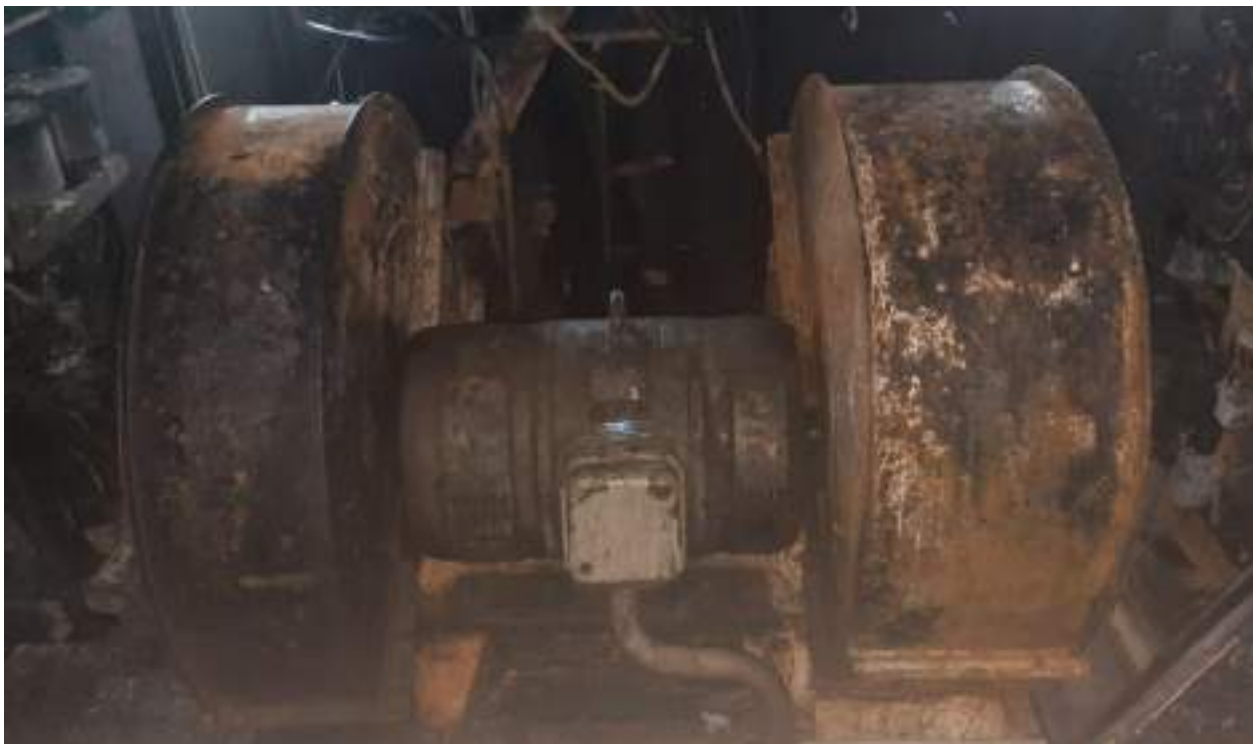
Foto nr.4. Grup ventilație boghiu 2 afectat termic
